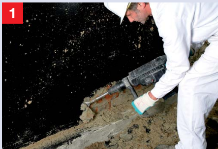
1 Entfernen der Altbeschichtung Im hochbelasteten Bereich des Fußpunktes ist die Altabdichtung vollständig bis auf den mineralischen Untergrund zurückzubauen.
