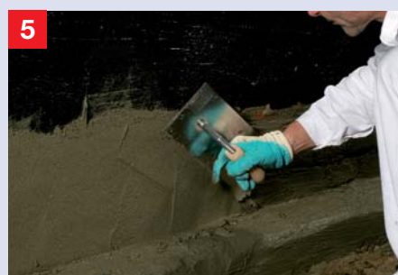
5 Egalisierung mit Dichtspachtel Frisch in frisch werden alle Unebenheiten bis 50 mm mit dem Remmers Dichtspachtel egalisiert.
