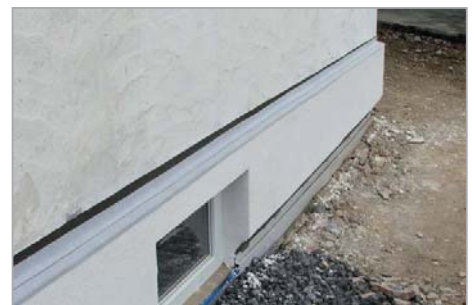
Fertige Ausführung des gedämmten Sockelbereiches mit Sockelschiene für das Dämmsystem im Wandbereich.
