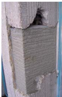
Schichtweiser Auftrag von Vergussmörtel quellfähig, aufräumen der Oberfläche zur Gewährleistung der Kornverzahnung.
