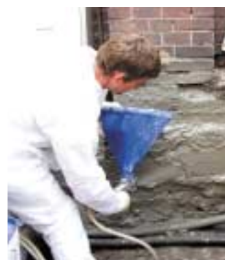
Stufe 1 und 2 der vertikalen Bauwerksabdichtung: Grundverkiegelung und Tiefschutz im Porengefüge mit Kiesel; Auftrag von Sulfatexschlämme und Dichtspachtel zum Schließen von Fehlstellen und offenen Fugen.
