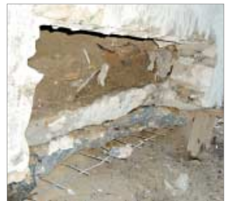
Schadensbild: Fehlende Verbindung zwischen Kellerwand und der Betonsohle
